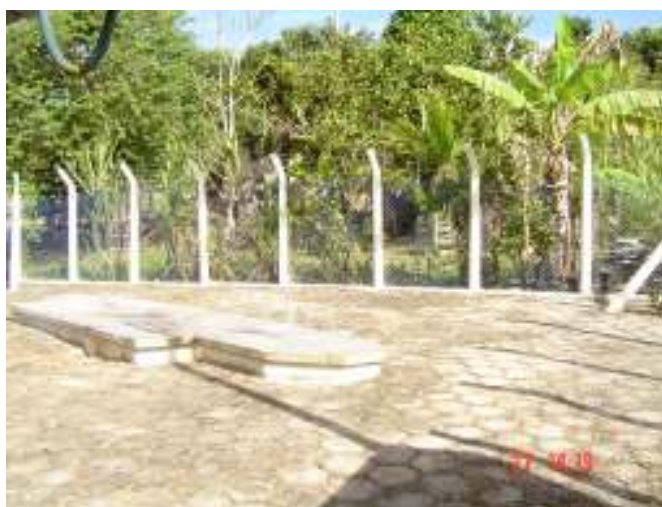
Foto 3: Sistema de Tratamento de Esgoto – Filtro biológico
