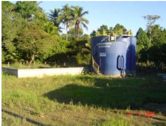
Foto 2: Estação de Tratamento de Esgoto de Guaraná
